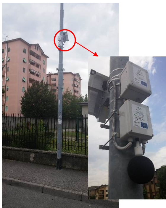
Figura 4. Esempio di sensore installato su palo della luce.
