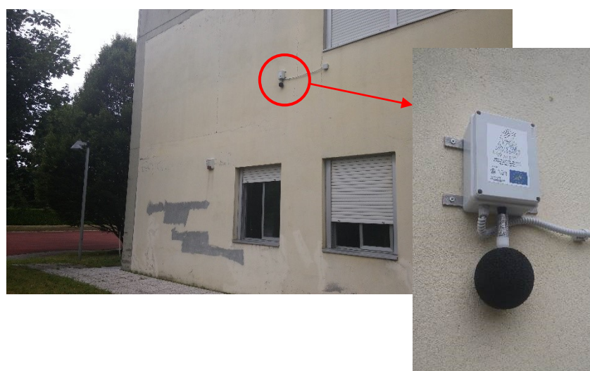
Figura 3. Esempio di sensore installato sulla facciata di un edificio pubblico.
