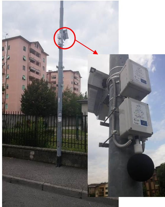
Figura 4. Esempio di SSMR installato su palo della luce.
